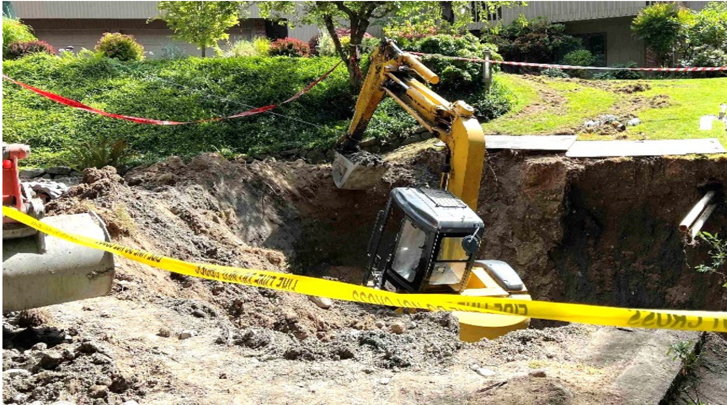
Fotografía 1. Vista de la escena del incidente que muestra las paredes con pendiente pronunciada y sin protección de la zanja.
