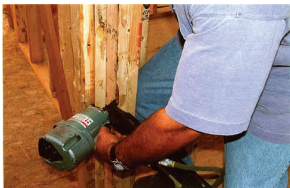
Uso peligroso de una pistola de clavos
