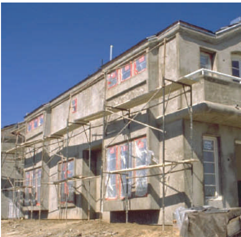
Andamio sin barandales
