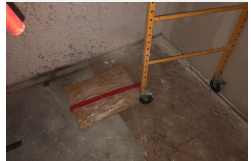
Foto 2: Cubierta de madera contrachapada no asegurada sobre el agujero del piso abierto.
