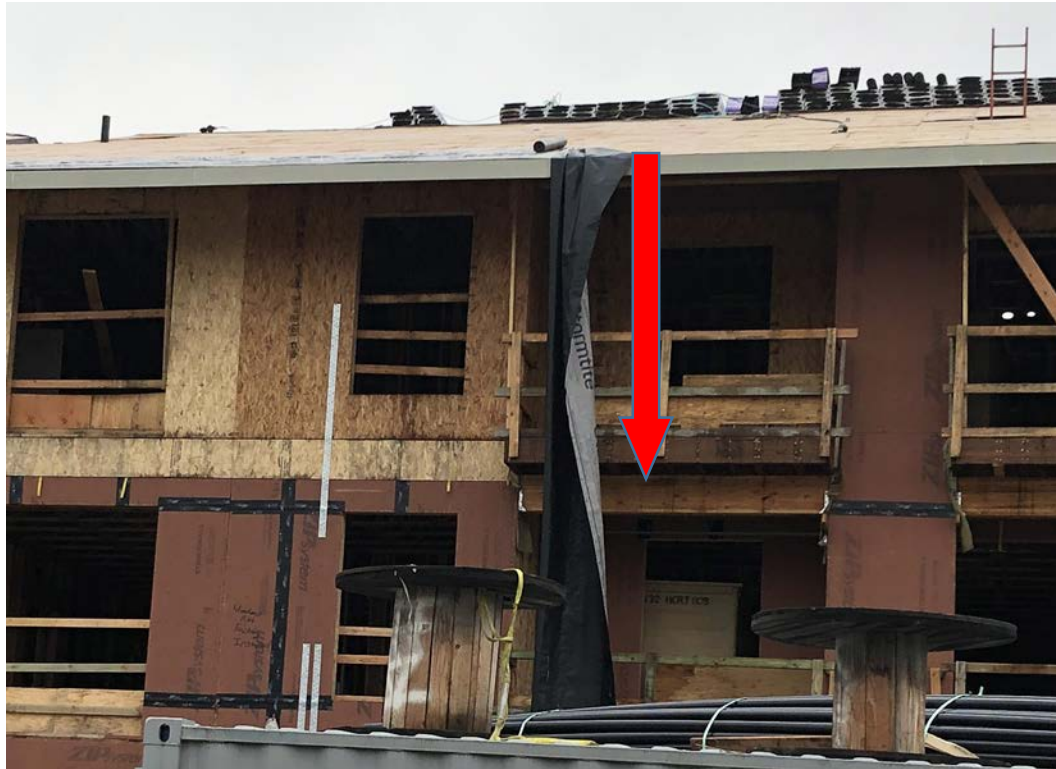
Foto 2. Escena del incidente que muestra la ubicación donde el techador cayó del techo desde 30 pies de altura.
