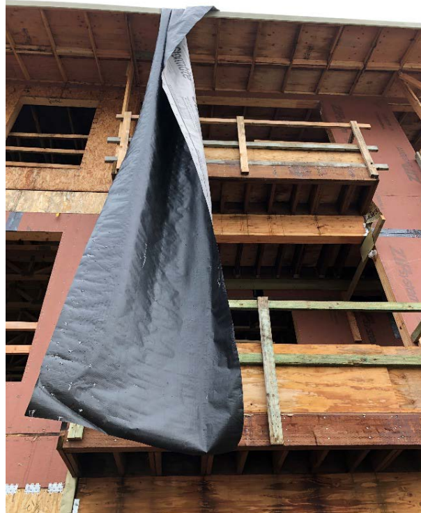
Foto 3. Contrapiso del techo al que intentó agarrarse mientras se caía.
