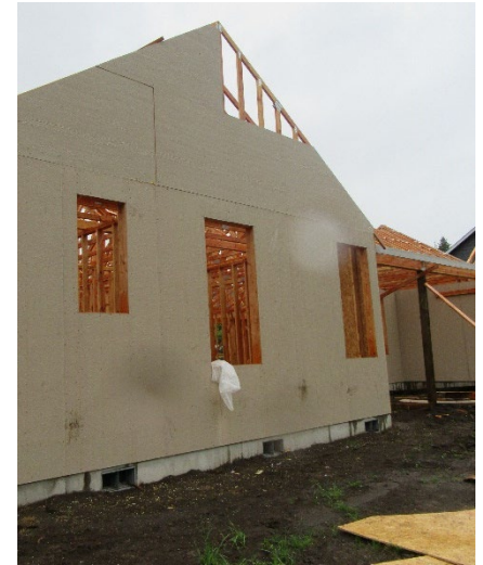
Costado de la casa en donde el instalador de estructuras colocó la escalera de extensión sobre tierra suave. Mientras subía, esta se deslizó y el trabajador cayó ocho pies.
