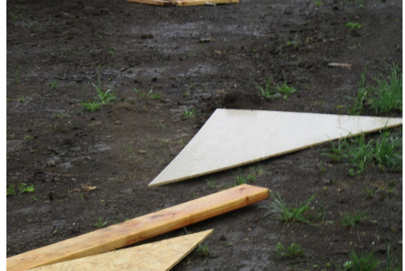
Fotografía 3. Lámina de contrachapado que el instalador de estructuras planeaba colocar en el fadón de la casa.
