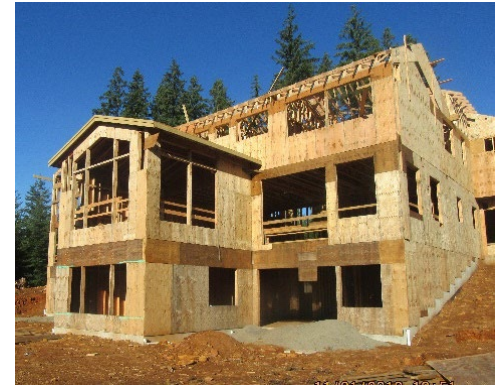
Casa donde un instalador de estructuras cayó 25 pies desde el techo revestido inferior trasero. No estaba usando protección contra caídas.
