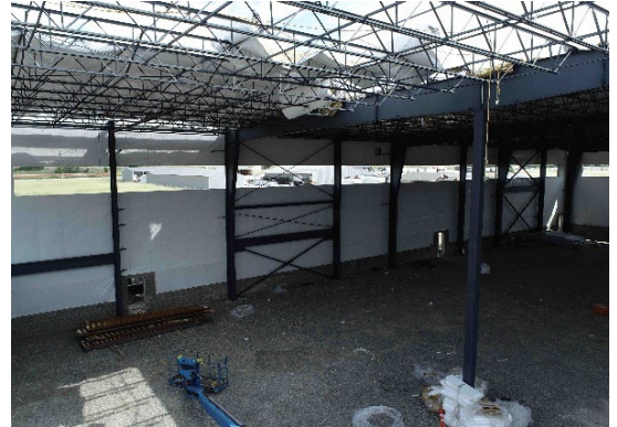
Interior del almacén donde el instalador de techos cayó 33 pies desde el techo sobre un piso de grava.
