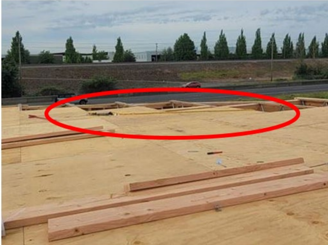
Fotografía 3. Anclaje de protección contra caídas, elemento de amarre amortiguador, y cuerda salvavidas cerca del borde delantero de la cubierta del techo desde donde cayó el trabajador.
