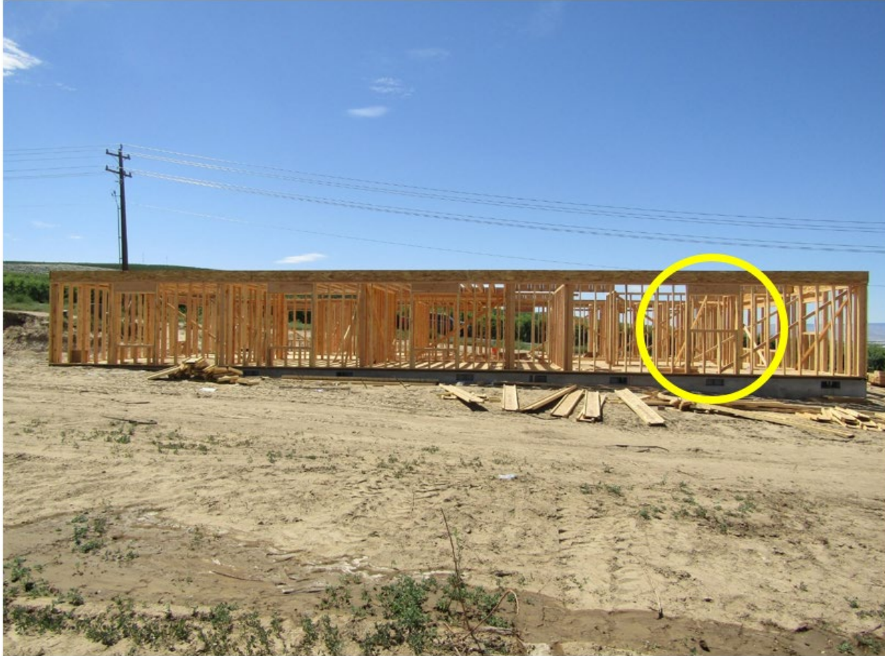
Fotografía 3. El círculo muestra el sitio en donde cayó el instalador de estructuras.
