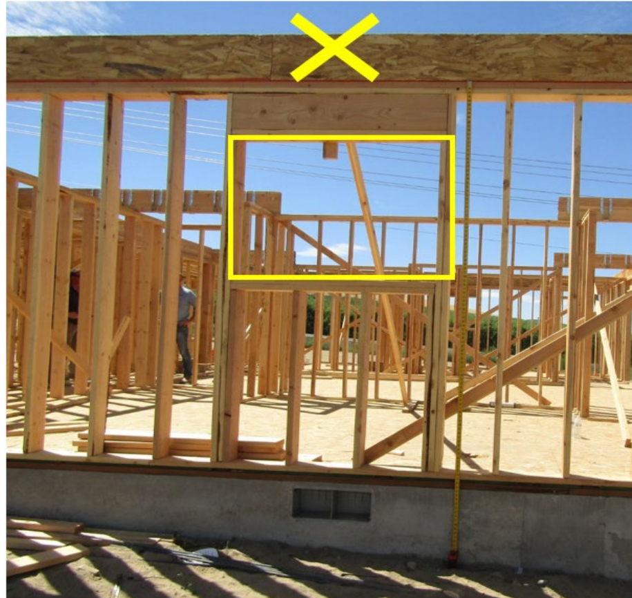
Fotografía 1. El instalador de estructuras cayó de la viga de borde (x) sobre la abertura de la ventana y hasta el entablado del piso.
